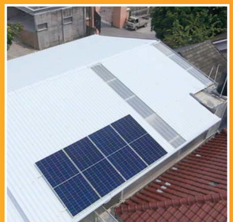
Sukoharjo - Jawa Tengah 2,4 kWp
