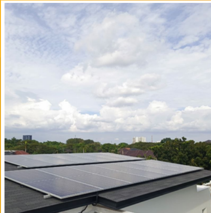
Semarang - Jawa Tengah 10 Panel | 6,2 kWp
