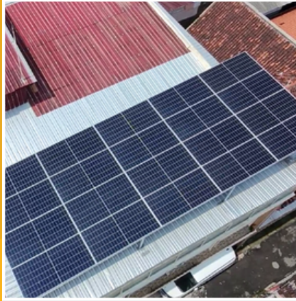
Sukoharjo - Jawa Tengah 20 Panel | 12,4 kWp
