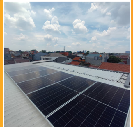
Bekasi - Jawa Barat 9 Panel | 5,5 kWp
