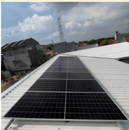
Cinere - Depok, Jawa Barat 10 Panel | 6,2 kWp
